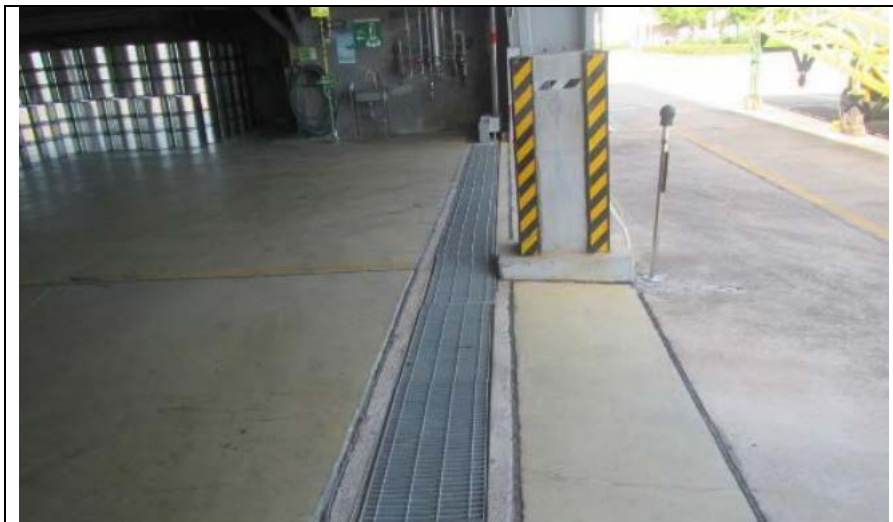
桶装库区，设防雨、防渗漏设施，设有溢流/泄露收集设施
